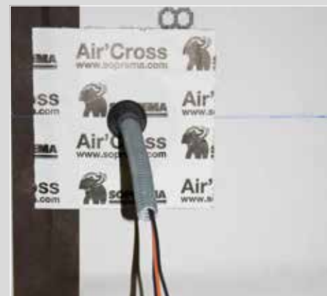
La contre-cloison est montée à l'avancement et favorise le passage des réseaux.
